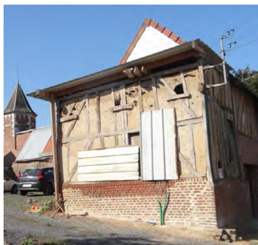
Mur en pan de bois et torchis endommagé
